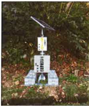
設置された監視カメラ
